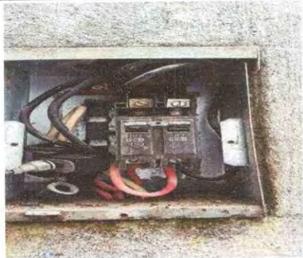
Foto1: RH. La caja principal de energía eléctrica está llena de sarro y mal estado.
