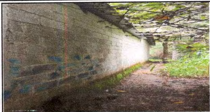
Foto 1: Parte de atrás del Módulo 1. Se observa que muestra humedad, debido a las constantes lluvias.
