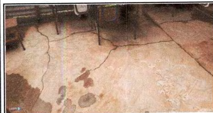
Foto 5: Aula 1 del módulo 1, Se puede observar el agrietamiento del entortado debido al mal estado del suelo por el ingreso de lluvias.
