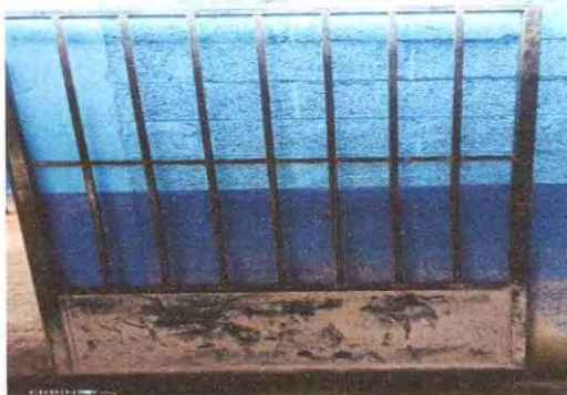
Foto1: Porton principal. Se observa el mal estado del porton ya que por las constantes lluvias se ha oxidado, por lo cual es necesario el cambio de planchas de metal.
