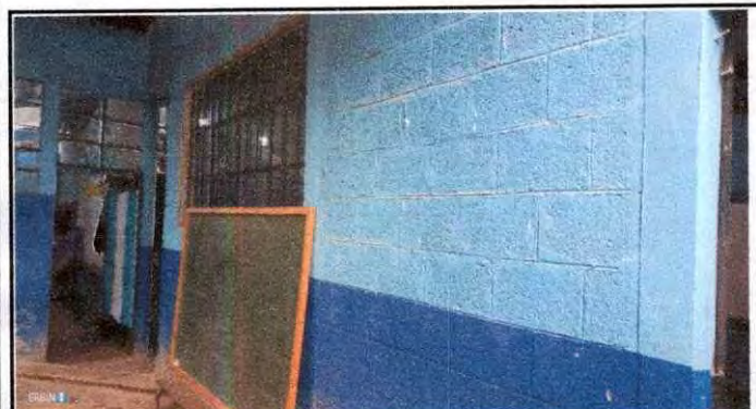
Foto 3: Parte Frontal del Módulo 1. El módulo tiene un aproximado de diez años de construcción. No cuenta con repello en ninguna de sus paredes, lo cual se afecta por la humedad de la lluvia.
