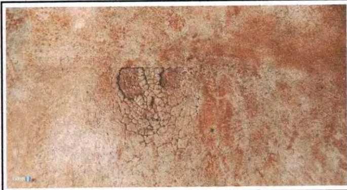
Foto 4: Piso pasillo Módulo 1. Se logra observar que debido al ingreso de las lluvias a afectado el piso, dando lugar a la pérdida del alisado.
