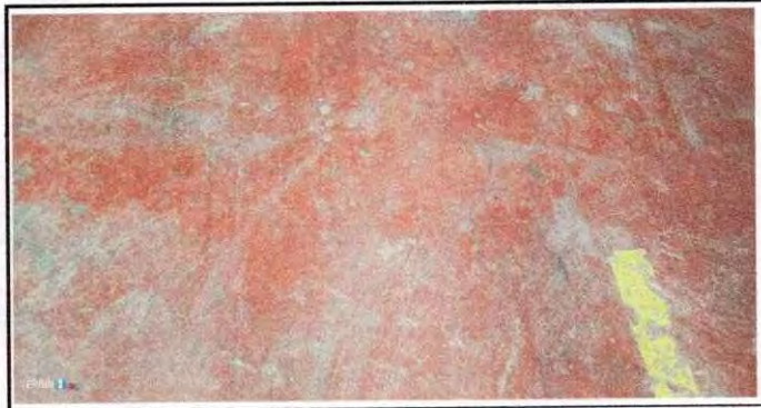
Foto 6: Aula 2 Módulo 1, Se observa el micro grietas en el piso, lo cual como resultado se tendrá el levantamiento del mismo.
