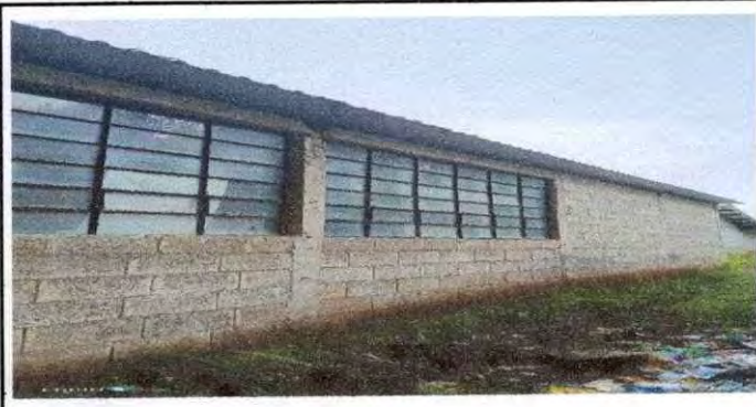
Foto 2: Parte lateral derecho Módulo 1. Se observa la acumulación de humedad, la cual afecta los materiales internos de las aulas.
