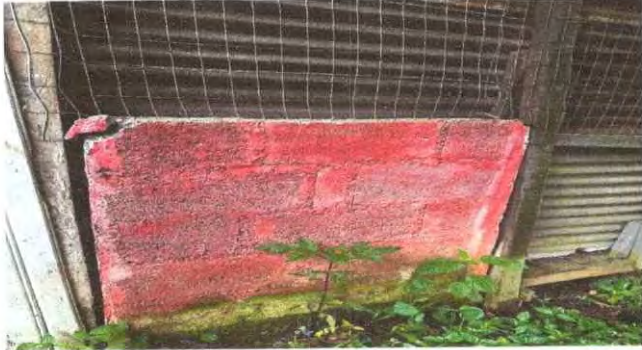
Foto 1: Muro perimetral Modulo 1. Se cuenta con un muro perimetral en mal estado e incompleto en algunas partes.
